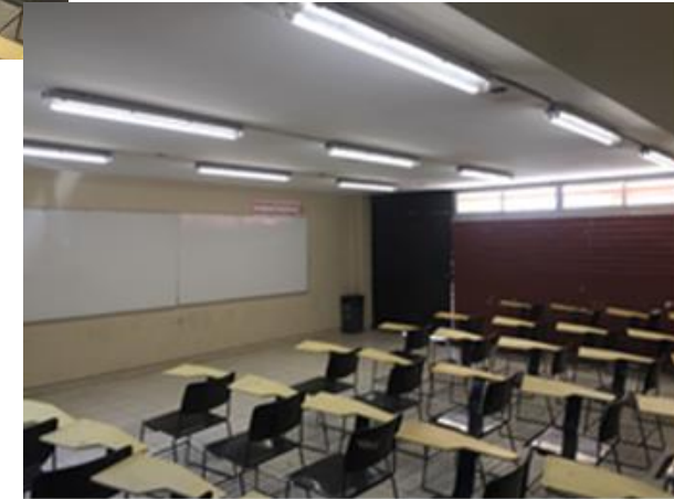
Aula A58 con sistema de iluminación LED.
